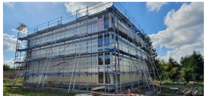
Im Rahmen des Richtfests konnten die Besucherinnen und Besucher auch die Innenräume begutachten.
